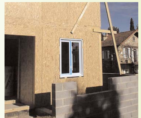
OSB pour recouvrir l'isolant bois
