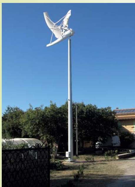
L'éolienne domestique installée à Grillon
